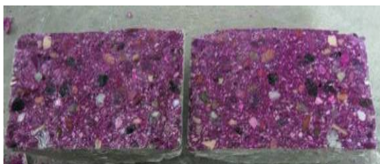
Fig. 137. Profundidad de carbonatación del H-0,65 100%.
